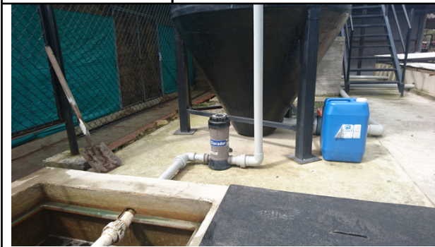
Foto No. 3. Cloración
