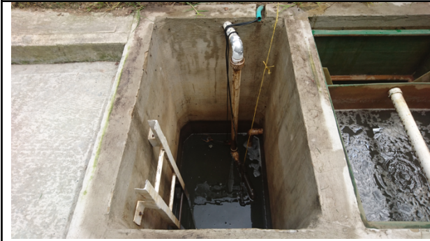
Foto No. 5. Tanque de bombeo hacia punto de vertimiento
