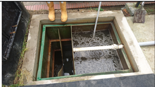
Foto No. 4. Caja de inspección interna
