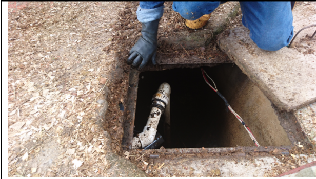
Foto No. 1. Tanque de bombeo hacia la PTAR
